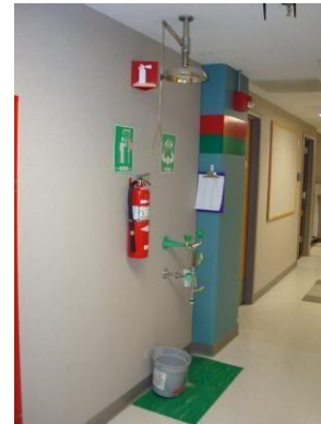
Duş ve göz yıkama ünitesi
